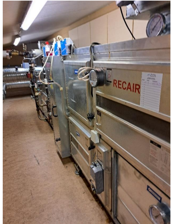
Kuva LVI 13: Vanhan osan toimistotiloja palveleva ilmanvaihtokone
