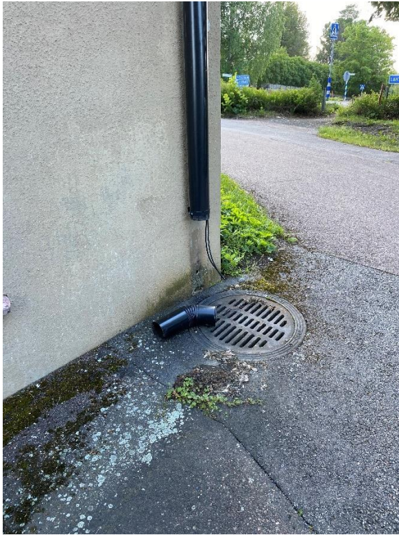
Kuva 3: Syöksytorven pää irti.
