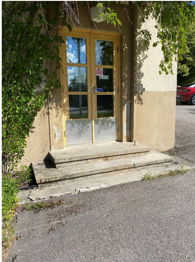
Kuva 1: Portaan betoni rapautunut
