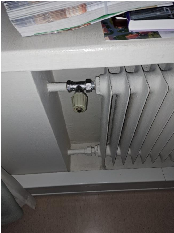
Kuva LVI 10: Vanha termostaattinen patteriventtiili
