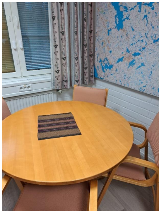
Kuva LVI 1: Vanha termostaattinen patteriventtiili
