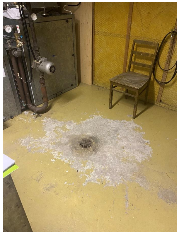
Kuva 10: LJH betonilattian maali ja pinnat huonot
