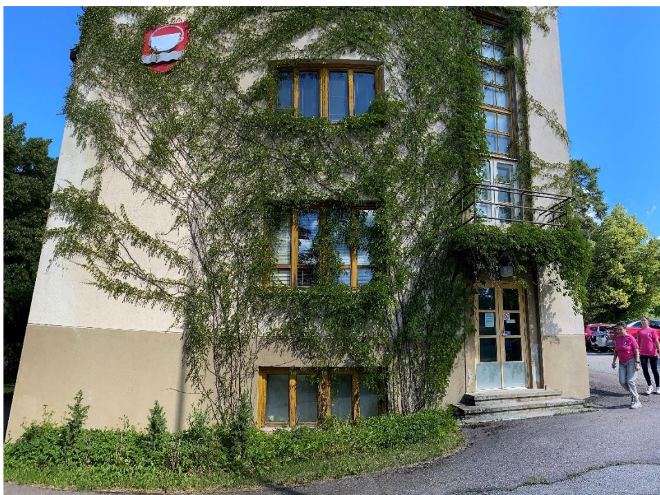
Kuva 2: Päädyn villiviini syytä poistaa; vaurioittaa rappausta
